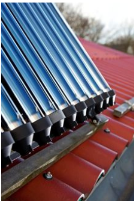
Figuur 3-4 Dakbeplating met de zonneboilers daarop bevestigd. Bron: Maarten Wiersma
